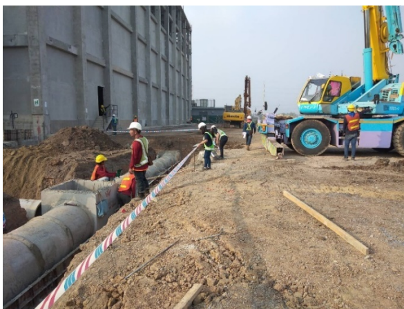
ภาพที่ 1-8 ภาพถ่ายกั้นบริเวณจุดที่มีงานความเสี่ยงสูง
