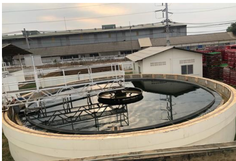
รูปที่ 2.13 แสดงบ่อตกตะกอน (Clarifier Tank)
