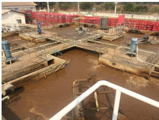
รูปที่ 2.12 แสดงบ่อบำบัดน้ำเสียแบบเติมอากาศ (Aeration Tank)
