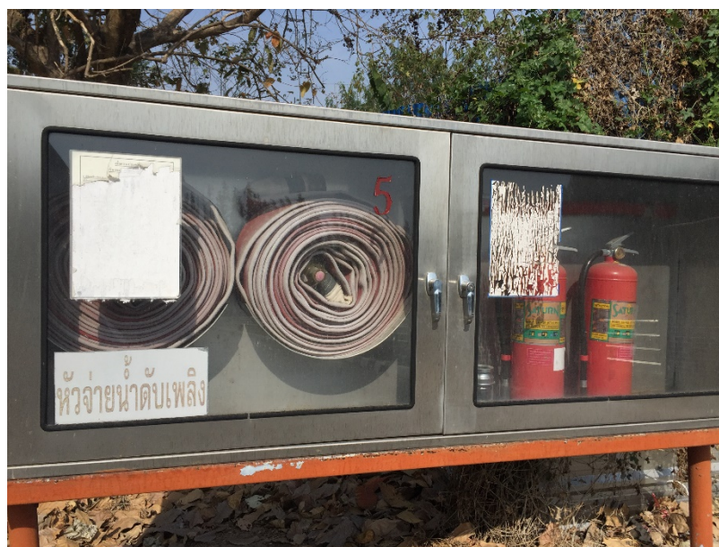
ภาพการตรวจสอบระบบน้ำดับเพลิง และถังดับเพลิงประจำตู้จัดเก็บ
