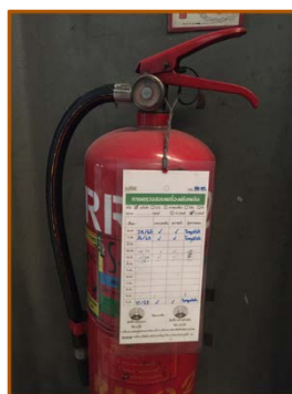
ภาพ 1-8 การตรวจสอบถังดับเพลิงประจำเดือน
