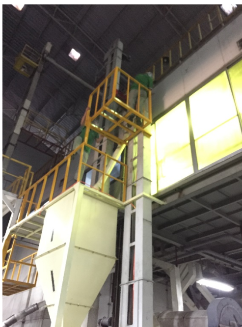
วิเคราะห์ความเสี่ยงจากงานทำความสะอาดกระพ้อลำเลียงข้าว
