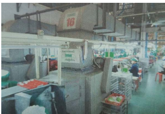
ภาพที่ 2-3 ลักษณะท่อลม
