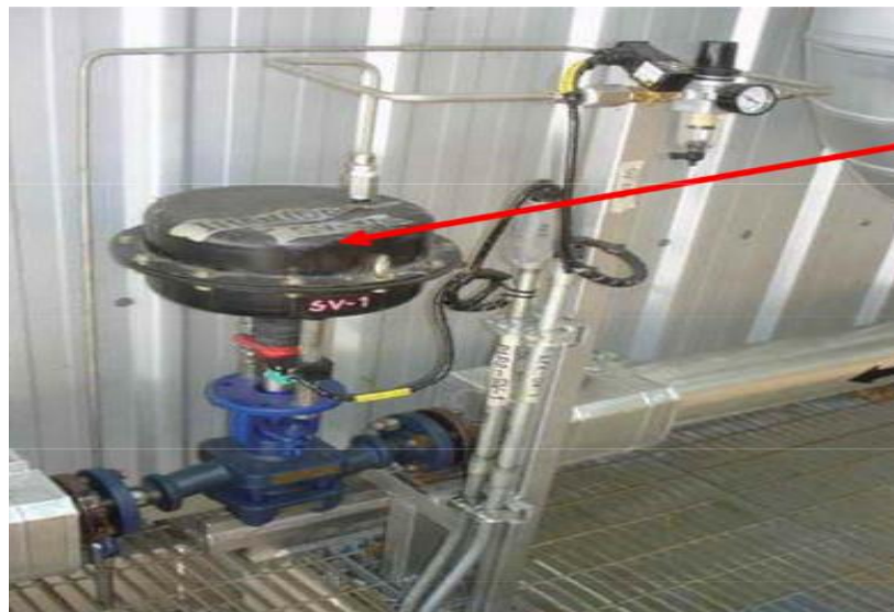
ภาพที่ 2.19 วาล์วระบายน้ำทิ้ง
