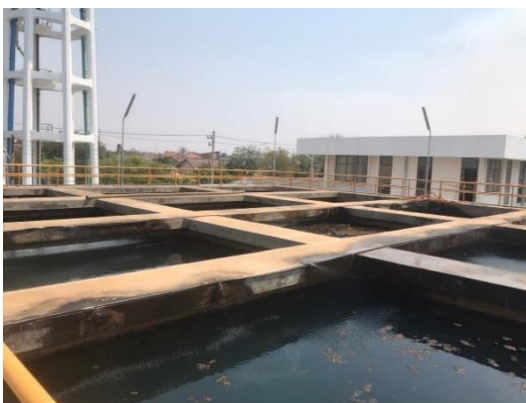
รูปที่ 2.3 ถังตกตะกอน
