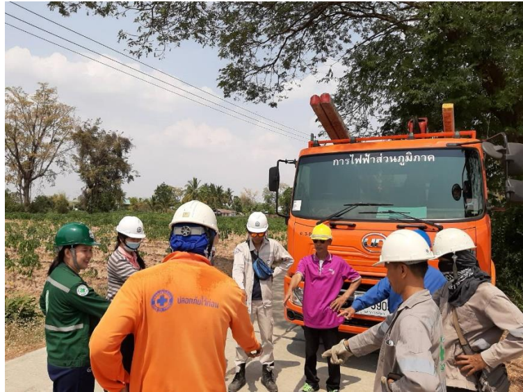
ภาพที่ 2-24 ภาพการสำรวจการทำกิจกรรม KYT ที่หน้างาน ปักเสา บ้านหนองขาม
