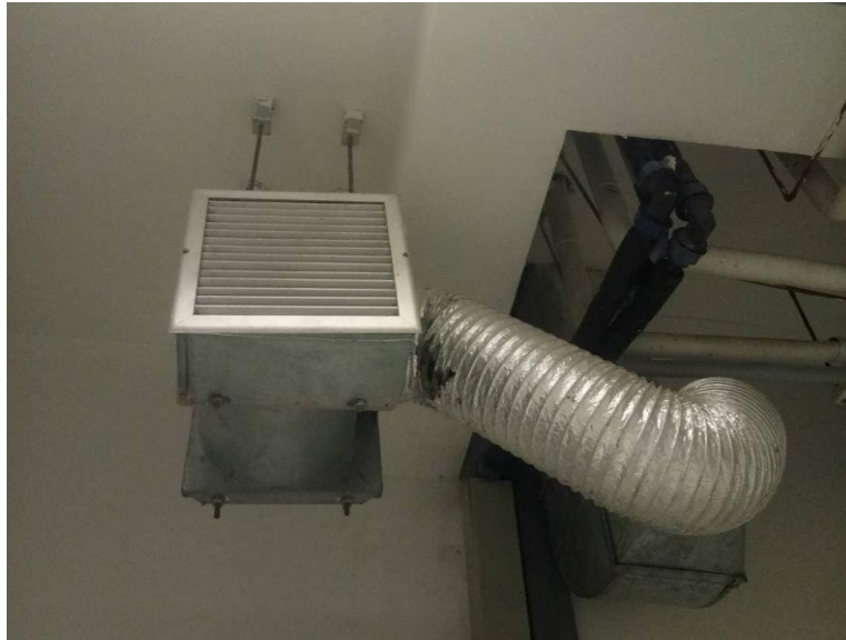
ภาพที่ 3.15 ระบบระบายอากาศ (Air Ventilation System)
