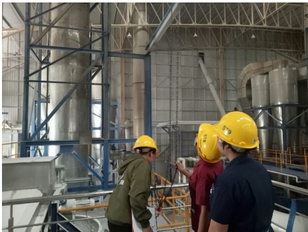
ตรวจเช็คและสายพานเครื่องจักรในไลน์การผลิต
