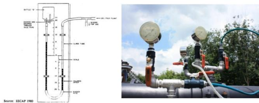
ภาพที่ 2.14 แสดงอุปกรณ์วัดความดันในท่อ (ที่มา : กรมโรงงานอุตสาหกรรม. 2553)
