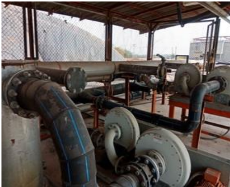
Blower อัดแรงดัน
