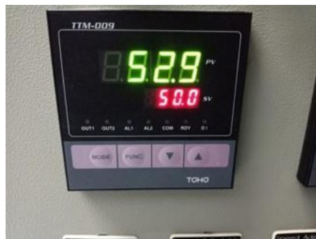
PID control รอบของBlower
