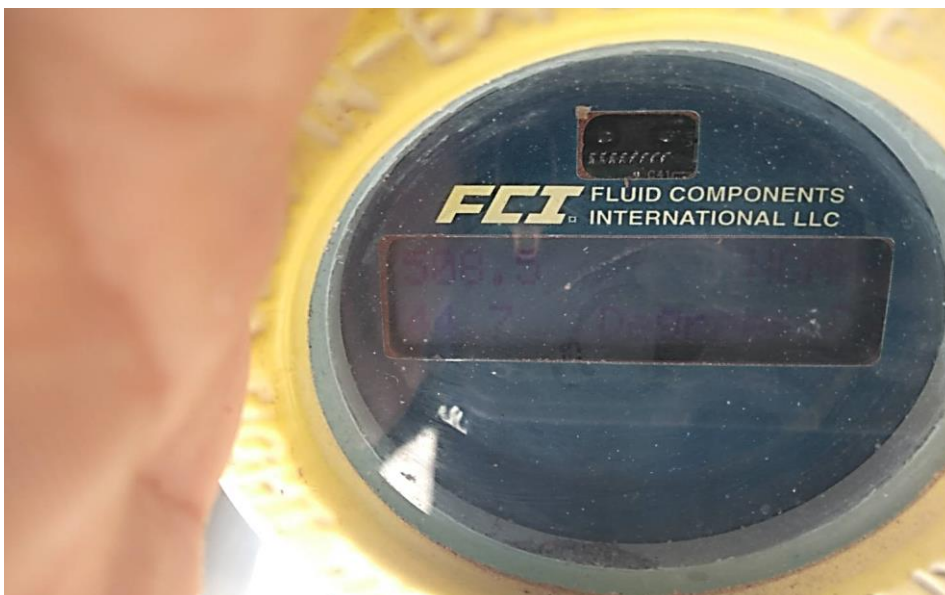
ภาพที่ 4.3 Flow meter ใช้วัด Flow ที่ไหลผ่านท่อ HDPE
