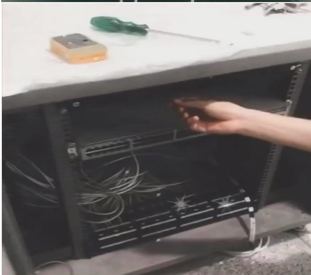
ภาพที่ 12 ติดตั้ง Switch ตึกใหม่
