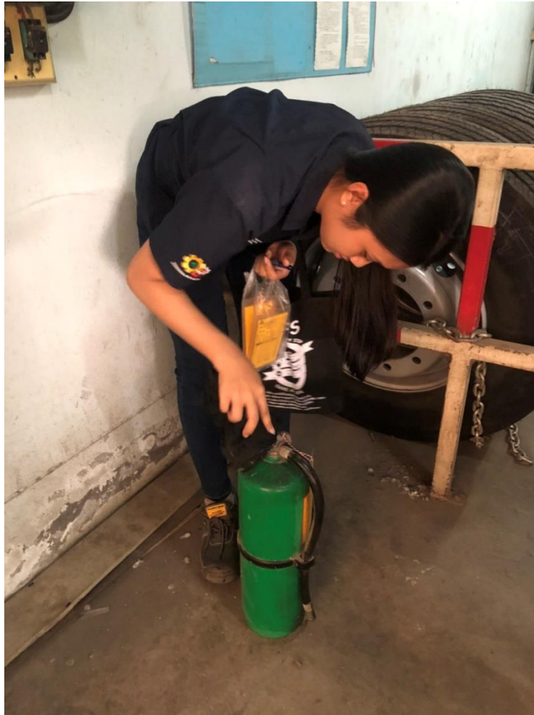
ภาพการตรวจเช็คและทำความสะอาดถังดับเพลิง
