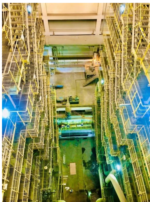
ภาพที่ 1-4 Boiler บริษัท ซีแอนด์จี เอ็นไวรอนเมนทอล โปรเจ็คชั่น (ประเทศไทย) จำกัด
