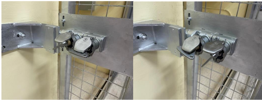
ภาพที่ ก.10 แสดงการเปิดประตูกรงเหล็กห้องฉายรังสี
