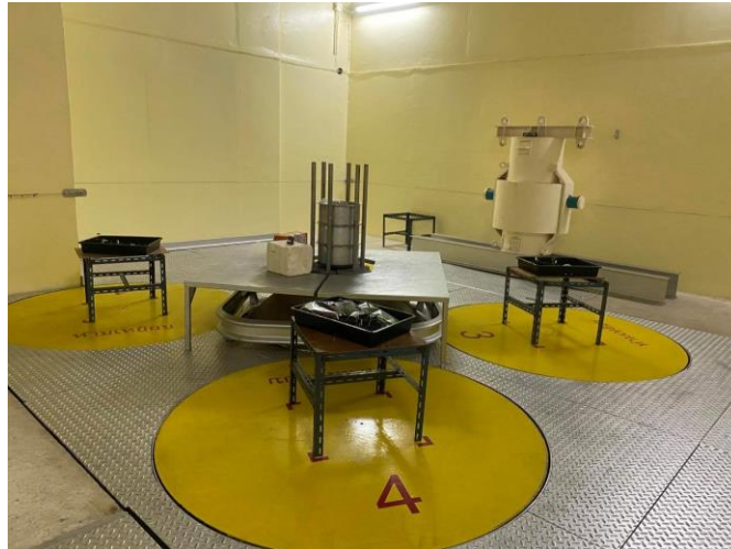
ภาพที่ 15 ภายในห้องฉายรังสีแกมมา
