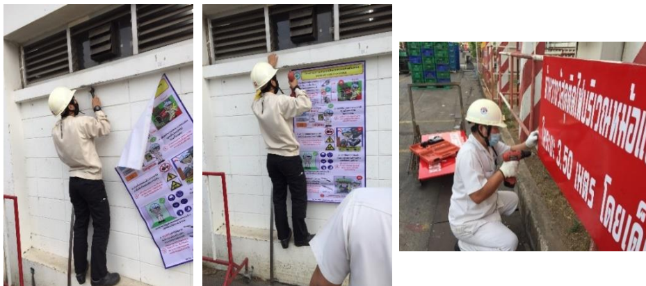
ภาพที่ 30 ติดป้ายวัฒนธรรมความปลอดภัยการทำงานกับเครื่องจักร และติดตั้งป้ายห้ามวางสิ่งของใต้หม้อแปลงไฟฟ้าแรงสูง
