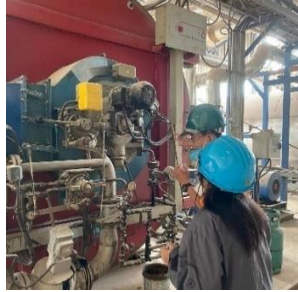
ภาพที่ 1-10 เดินไลน์ผลิตดูการทำงานของ hot oil boiler
