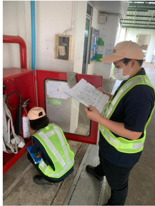
ตรวจเช็คถังดับเพลิงและตู้เก็บสายส่งน้ำ
