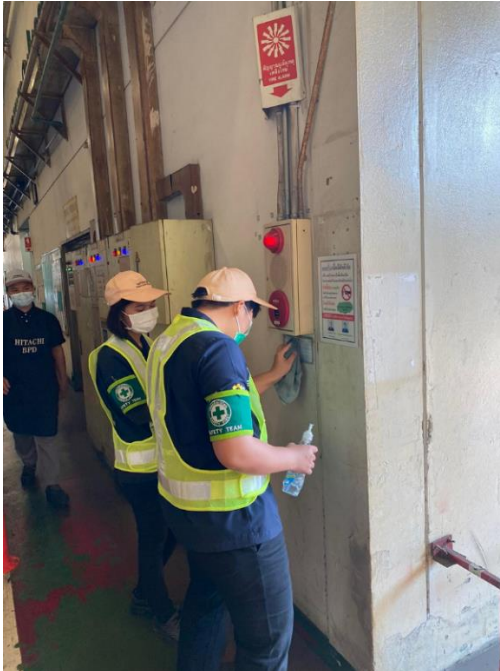
ตรวจเช็คสัญญาณแจ้งเหตุเพลิงไหม้
