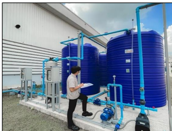
ตรวจสอบสภาพการใช้งานแท็งก์เก็บน้ำฝน
