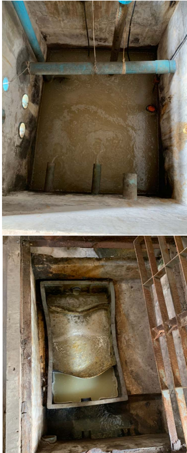
ภาพที่35,36,37,38 ตรวจสอบระบบระบายน้ำทิ้งและตรวจวัดค่า BOD,DO,pH ,TDS
