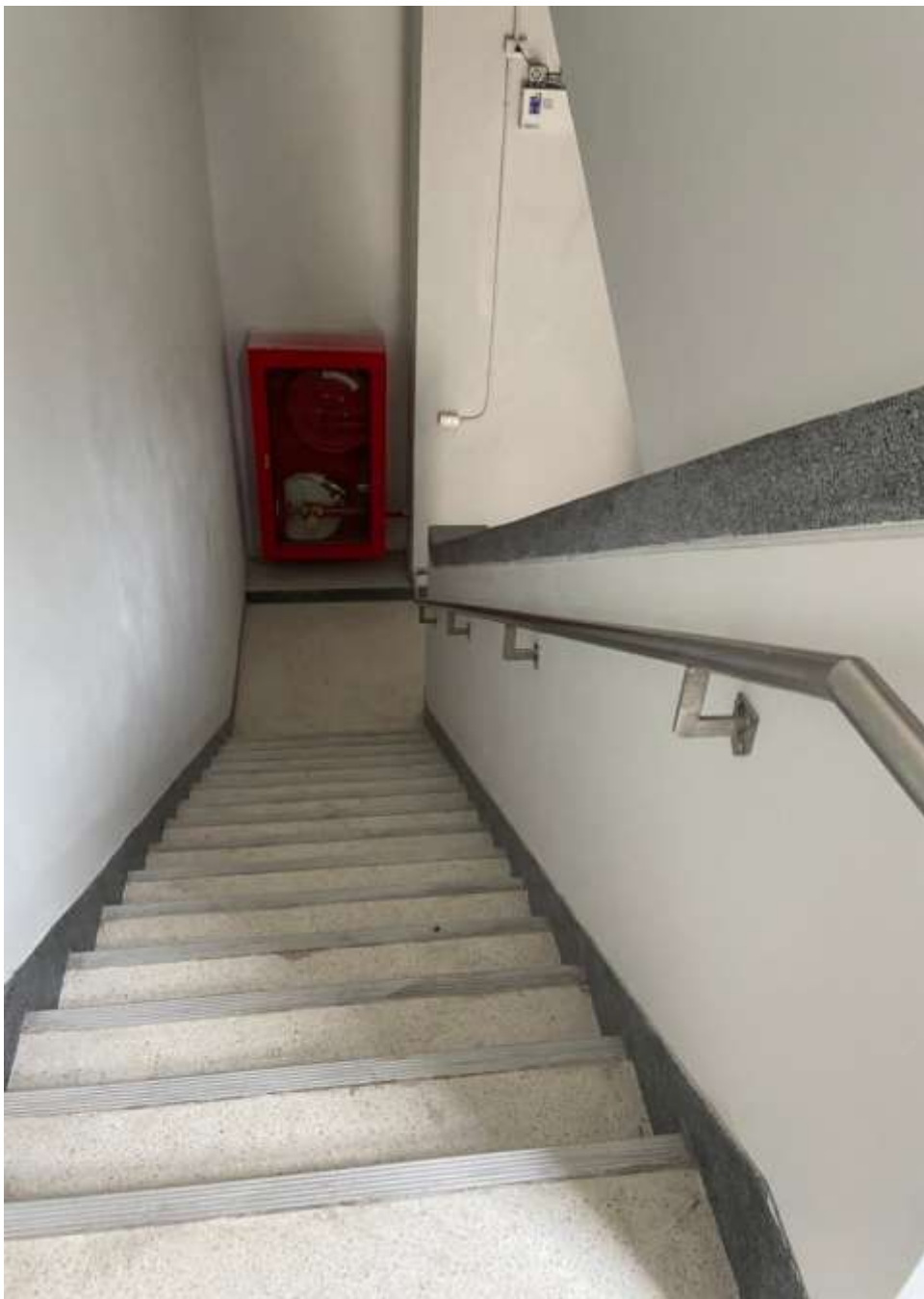
ภาพที่ ง - 2 อุปกรณ์ดับเพลิงติดตั้งที่ทางหนีไฟชั้น 1 ฝั่งคณะสาธารณสุขศาสตร์
