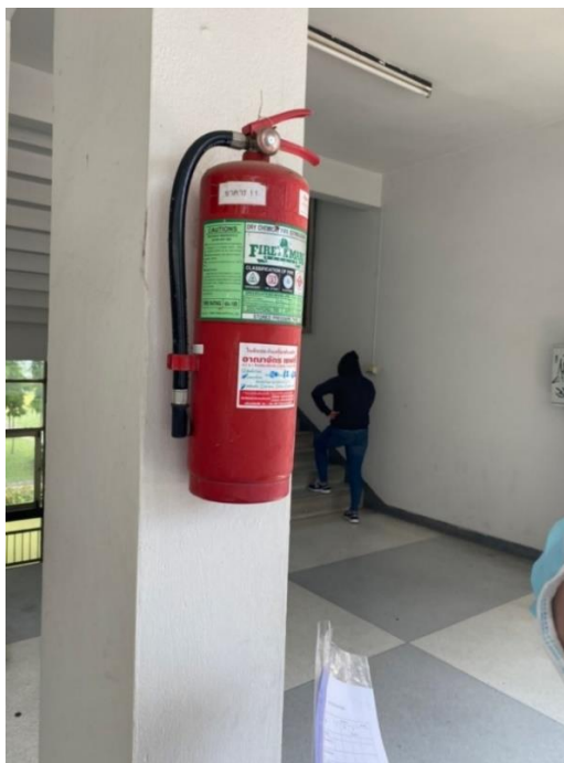
ภาพประกอบที่ 8 ถังดับเพลิง
