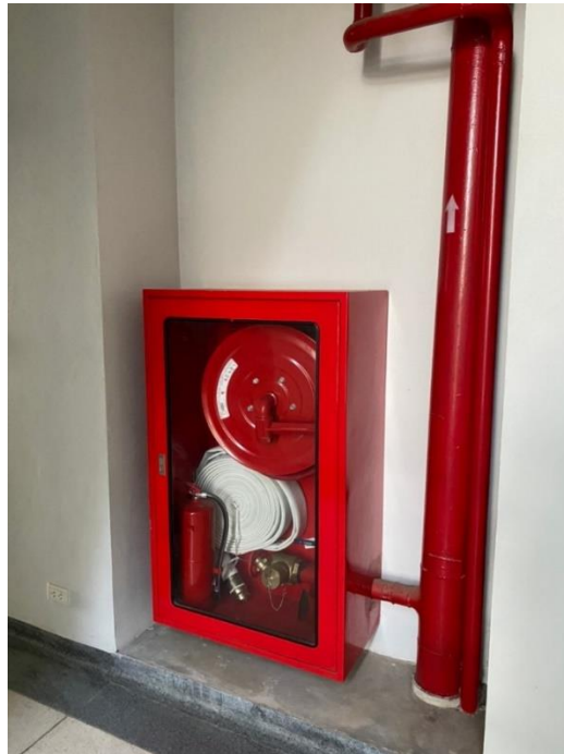
ภาพประกอบที่17 ตู้สายฉีดน้ำดับเพลิง
