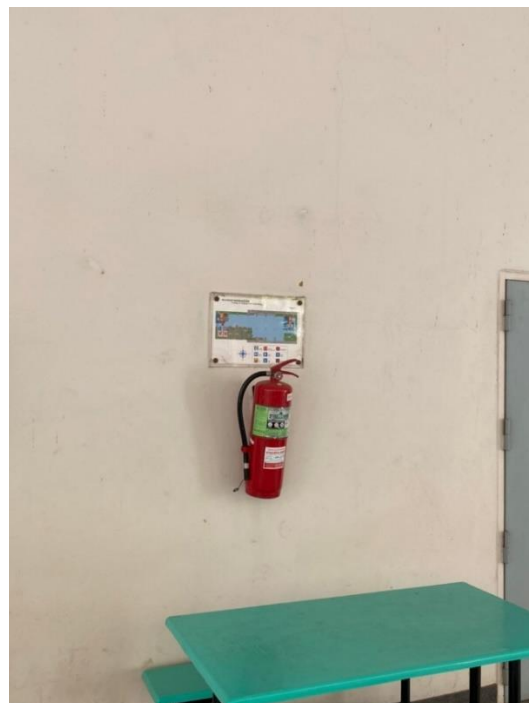
ภาพประกอบที่14 ถังดับเพลิง
