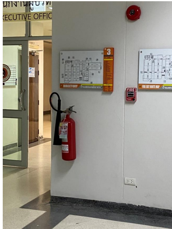
ภาพประกอบที่ 3 ถังดับเพลิงหน้าลิฟท์ ชั้น 3
