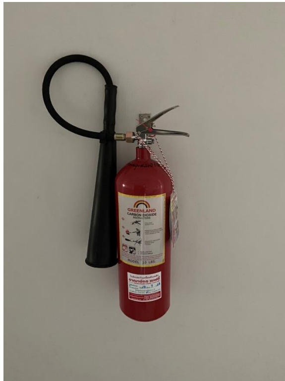
ภาพประกอบที่ 6 ถังดับเพลิง ชั้น 4
