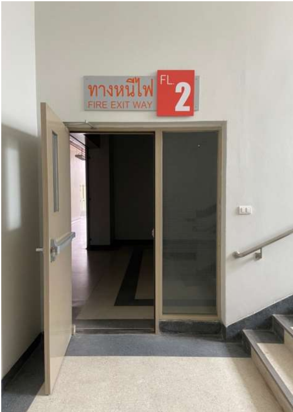
ภาพที่ ง - 7 ทางหนีไฟชั้น 2 ฝั่งคณะเทคโนโลยีอุตสาหกรรม
