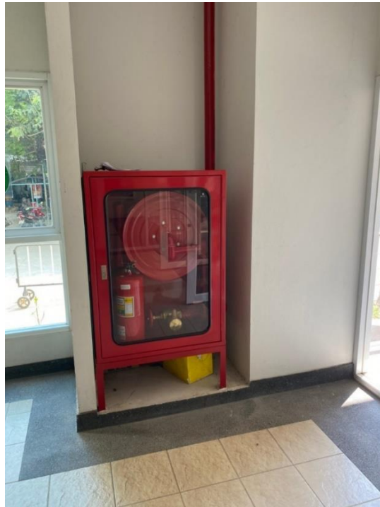
ภาพประกอบที่ 9 ตู้สายฉีดน้ำดับเพลิง
