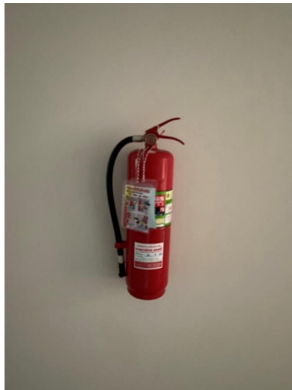
ภาพประกอบที่ 8 ถังดับเพลิงชั้น 4
