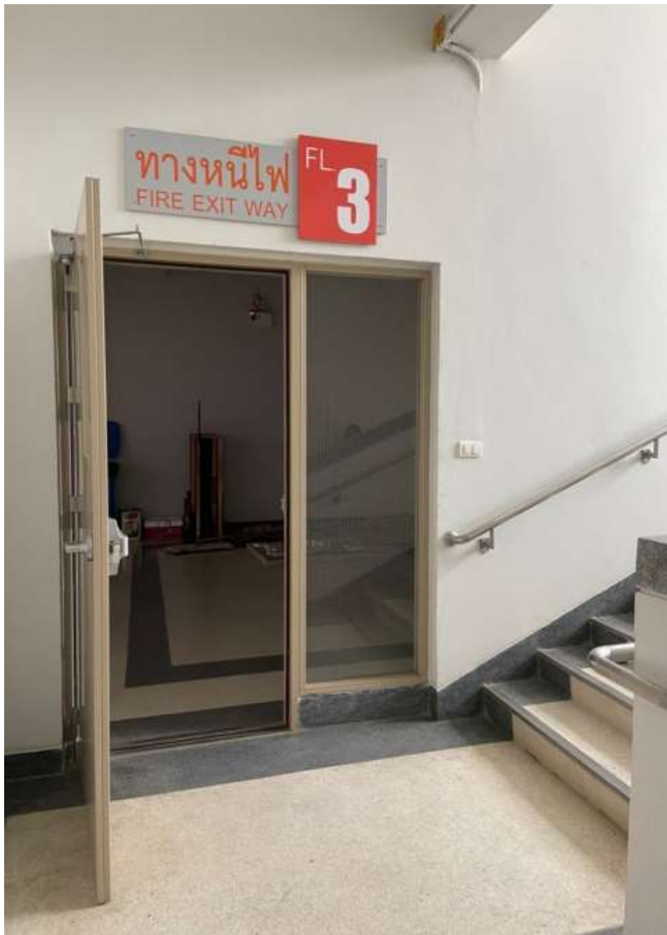
ภาพที่ ง - 8 ทางหนีไฟชั้น 3 ฝั่งคณะเทคโนโลยีอุตสาหกรรม
