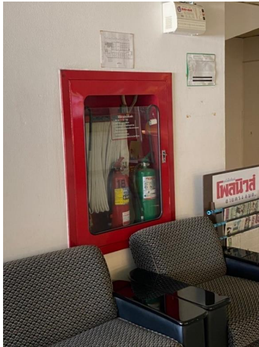
ภาพประกอบที่ 5 ตู้สายเก็บน้ำดับเพลิง
