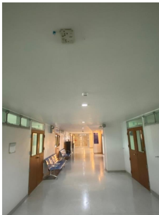
ภาพประกอบที่2 ระบบสัญญาณเตือนไฟไหม้
