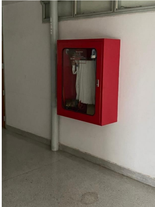
ภาพประกอบที่1 ตู้สายฉีดน้ำดับเพลิง
