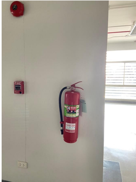
ภาพประกอบที่ 7 ถังดับเพลิงชั้น 4
