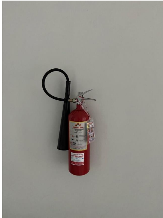
ภาพประกอบที่ 9 ถังดับเพลิง ชั้น 4
