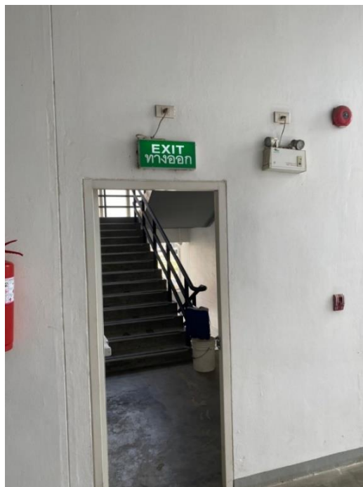
ภาพประกอบที่16 ประตูทางออกฉุกเฉินและไฟฉุกเฉิน
