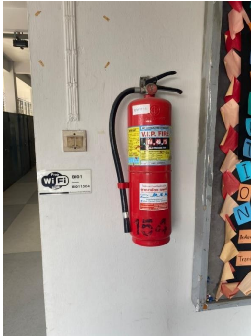
ภาพประกอบที่ 7 ถังดับเพลิง
