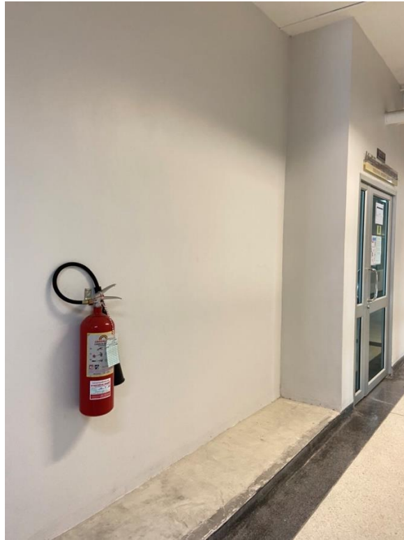
ภาพประกอบที่14 ถังดับเพลิงในห้องปฏิบัติการ
