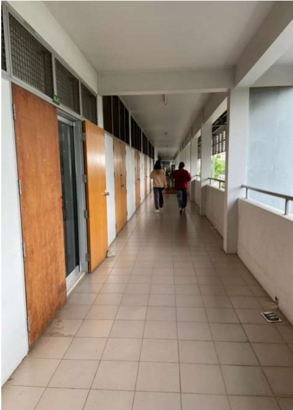
ภาพที่ ง - 11 ทางหนีไฟอาคาร 11
