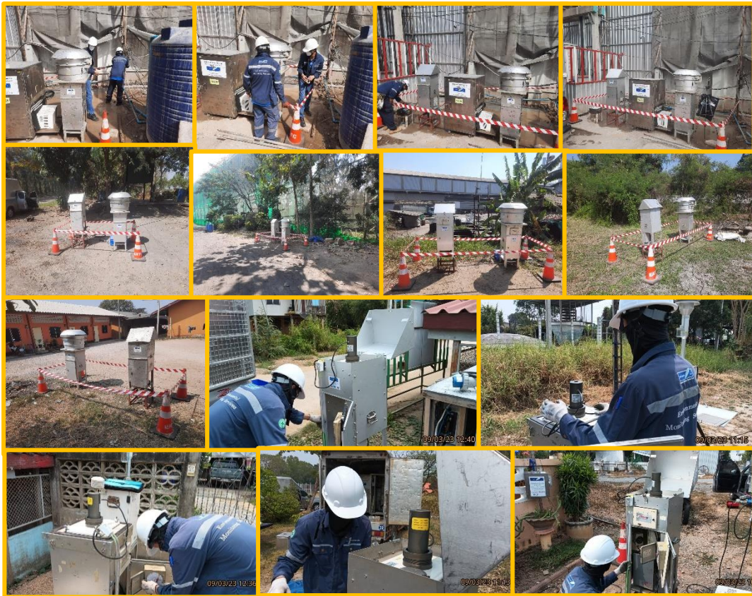
ภาพภาคผนวกที่ 6 บรรยากาศขณะติดตั้งสถานีตรวจวัดคุณภาพอากาศ
