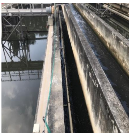
ภาพที่ 4 บริเวณบ่อตกตะกอนชั้นสุดท้าย
