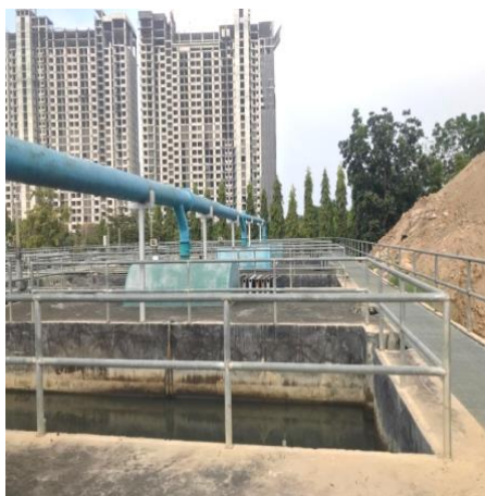
ภาพที่ 3 บริเวณบ่อเติมอากาศทั้ง 4 บ่อ
