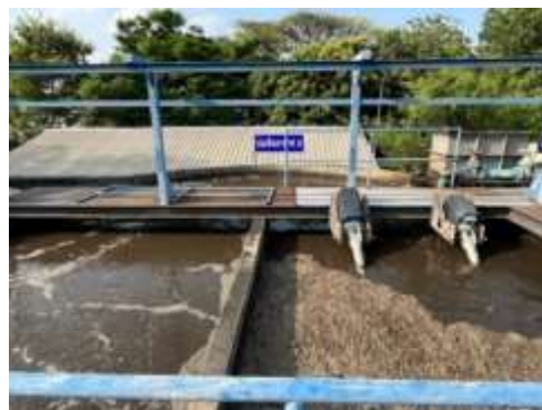
บ่อเติมอากาศ 2
