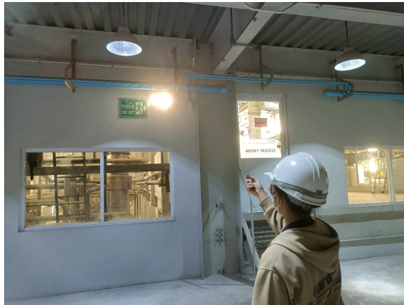
ภาพการตรวจเช็คสัญญาณไฟฉุกเฉิน
