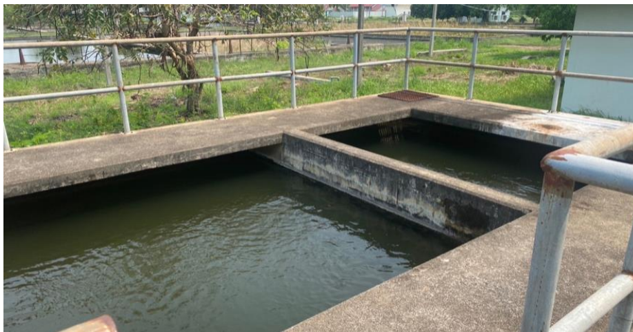
ภาพที่ 3.3 โรงสูบน้ำดิบ
