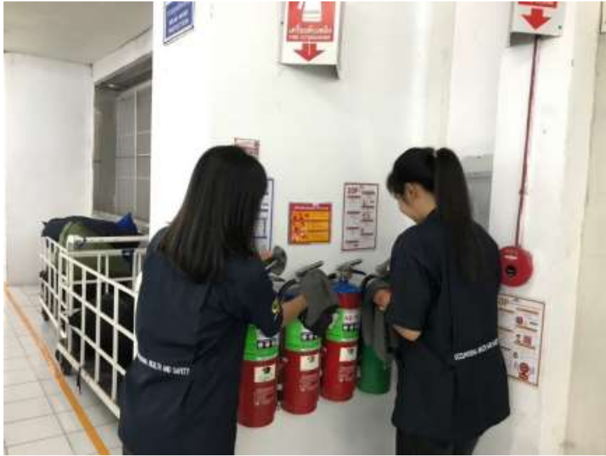
รูปภาพตรวจเช็คและทำความสะอาดถังดับเพลิง
