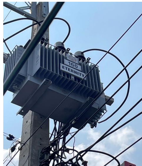
รูปที่ 3.4 หม้อแปลง 160 KVA ETERNITY
