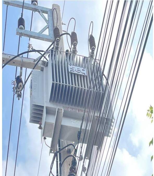
รูปที่ 3.5 หม้อแปลง 250 KVA TEN
