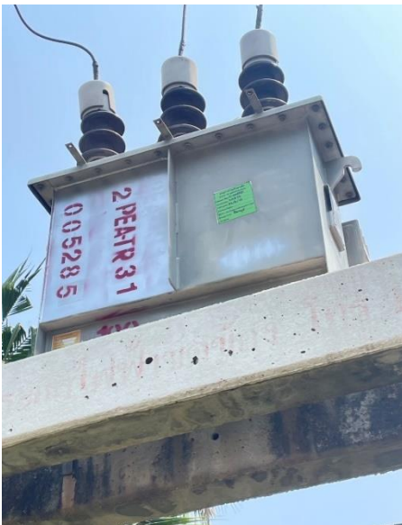
รูปที่ 3.3 หม้อแปลง 100 KVA Precise
