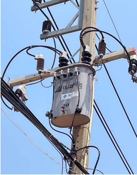
รูปที่ 3.2 หม้อแปลง 50 KVA CC Transformer
