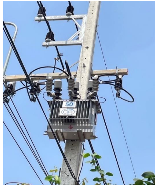
รูปที่ 3.1 หม้อแปลง 30 KVA เอกรัฐ
