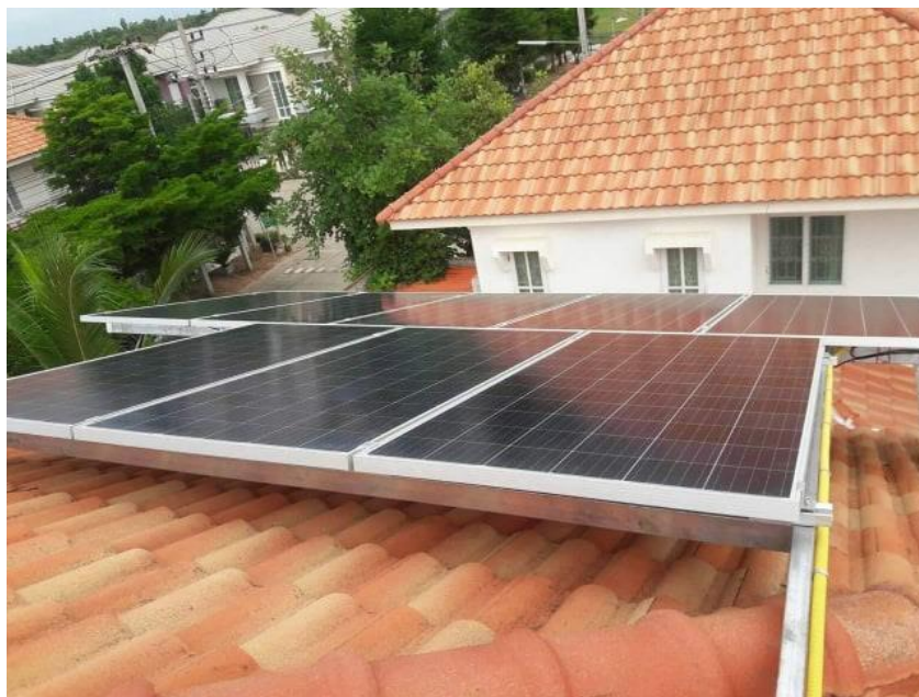
ภาพที่ 4.5 ติดตั้งแผงเซลล์แสงอาทิตย์และสายไฟ
