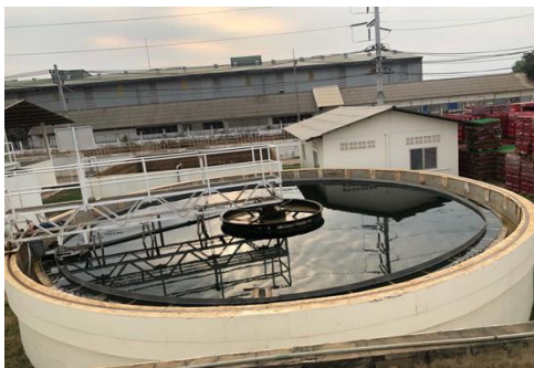
รูปที่ 2.13 แสดงบ่อตกตะกอน (Clarifier Tank)
