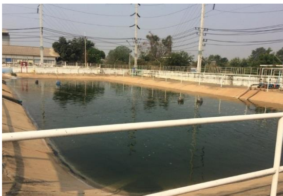
รูปที่ 2.15 แสดงบ่อน้ำทิ้ง (Effluent Pond)
