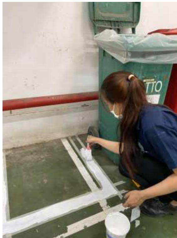
รูปภาพการทาสีระบุนบริเวณฐานรองรับน้ำจากอุปกรณ์ชำระล้างตาตุกเงิน
