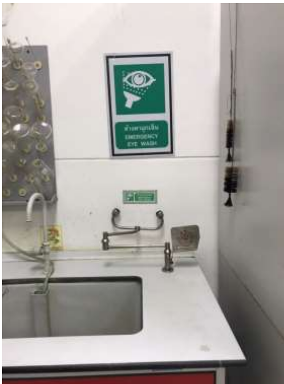
รูปภาพอุปกรณ์ชำระล้างตาฉุกเฉิน บริเวณห้อง Lab
