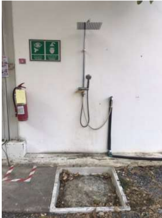
รูปภาพอุปกรณ์ชำระล้างตาฉุกเฉินบริเวณข้างห้องเก็บสารเคมี
