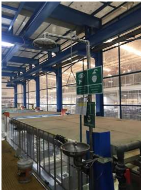
รูปภาพอุปกรณ์ชำระล้างตาฉุกเฉิน บริเวณ Auto PL/ด้านบนไลน์
