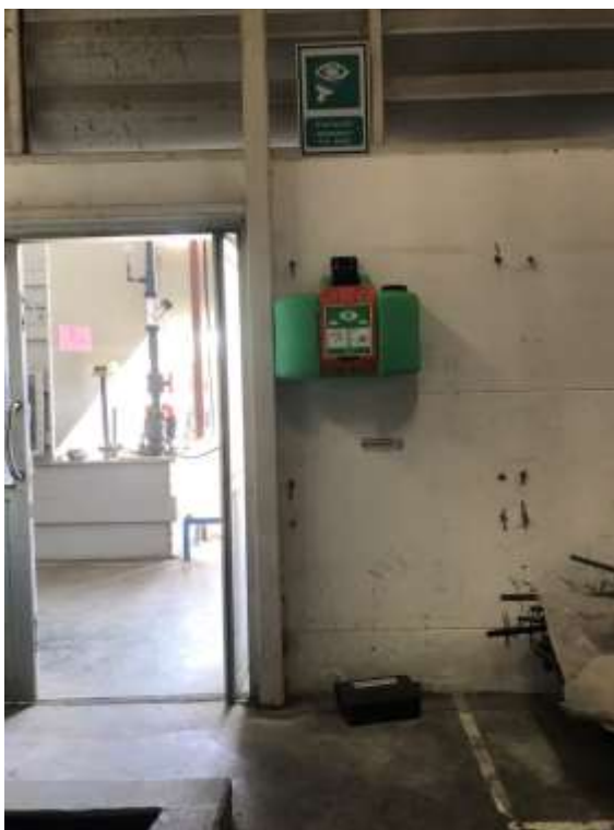
รูปภาพอุปกรณ์ชำระล้างตาฉุกเฉินแบบเคลื่อนที่ได้ บริเวณแผนกชุบ
