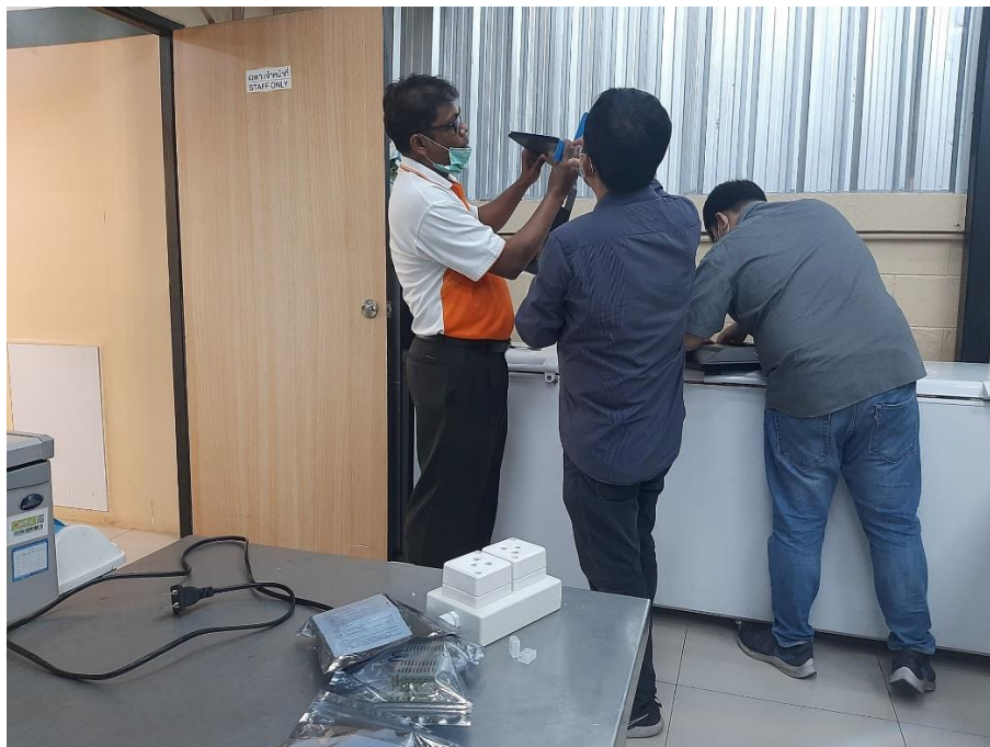
ภาพที่ 23 เตรียมอุปกรณ์เพื่อใช้ในการติดตั้งจอมอนิเตอร์ ครั้งที่ 2
