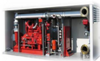
รูป 9 ระบบน้ำดับเพลิง
