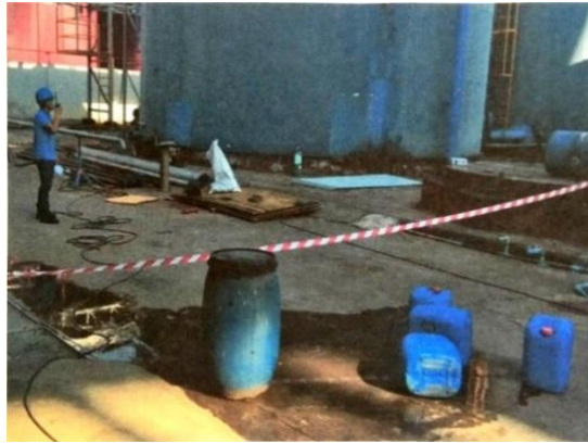
หัวหน้างานสั่งกันเขตพื้นที่การรั่วไหล เตรียมถังดับเพลิง
