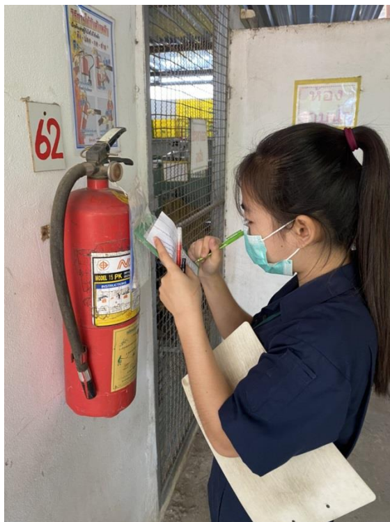
ตรวจเช็คถังดับเพลิง
