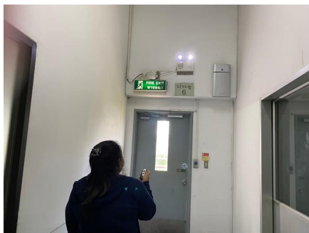
ภาพที่ 1-11 ตรวจสอบป้ายทางออกและไฟฉุกเฉิน
