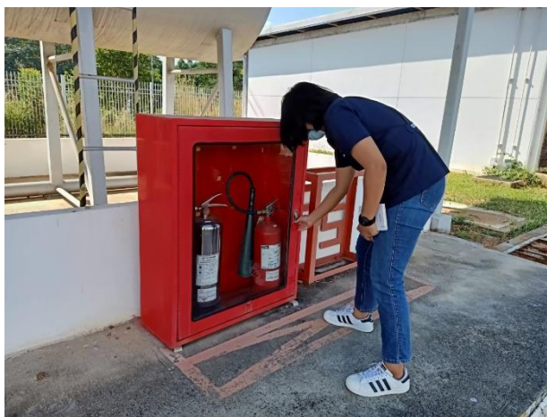
ภาพที่ 1-10 ตรวจสอบถังดับเพลิง
