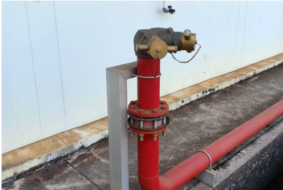
ภาพที่ 22 ตรวจสอบหัวรับน้ำดับเพลิง
