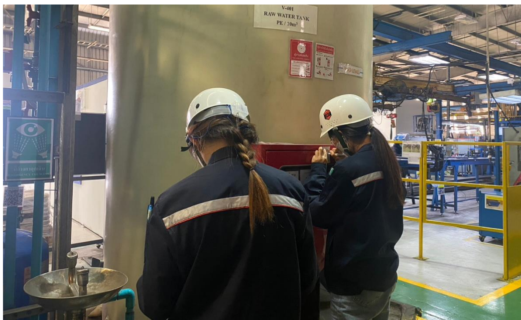
ภาพที่ 21 ตรวจสอบตู้ดับเพลิง
