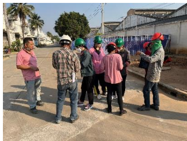
ภาพที่ 1.21เปิดใบอนุญาตทำงานที่มีประกายไฟ ตรวจสอบเครื่องมือ และควบคุมการทำงานของผู้รับเหมา
