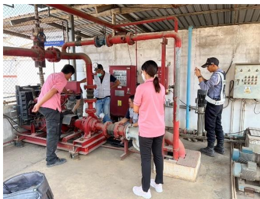
ภาพที่ 1.17 ตรวจสอบอุปกรณ์ป้องกันและระงับอัคคีภัย
