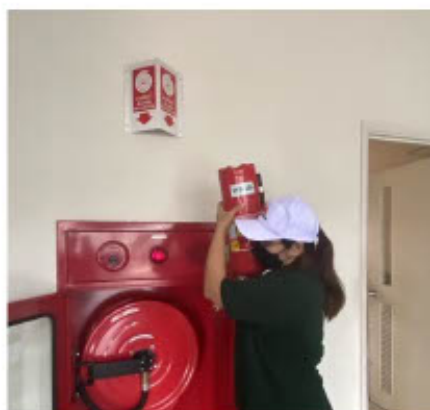
ภาพที่ 6 การตรวจถังดับเพลิงและอุปกรณ์ดับเพลิงประจำเดือน
