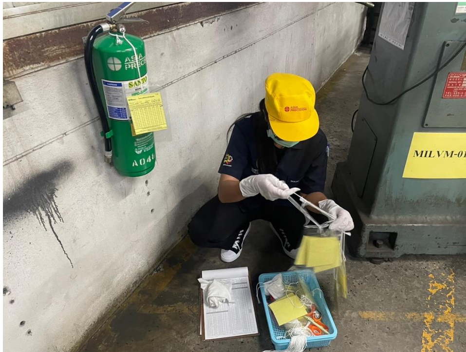
เปลี่ยนป้ายถังดับเพลิงและตรวจถังดับเพลิง 1 ครั้ง/เดือน
